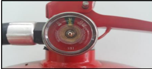
Jarum Kuning ( Pressure Gauge ) menunjukkan tekanan tabung APAMA
