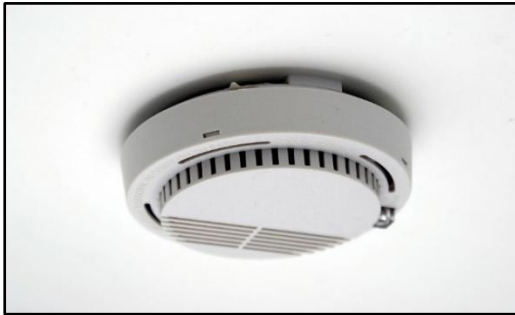
Satu unit smoke detector
